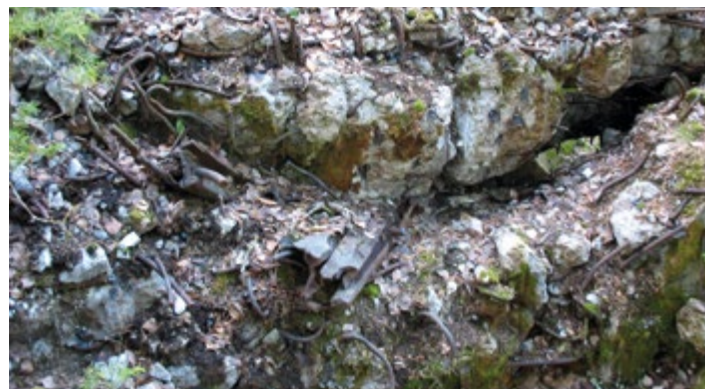
Повреждения напольной стенки дома Ink-7. Фото Е. А. Балашова
